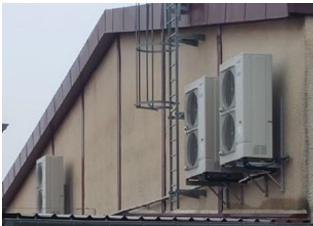
Pompe à chaleur
